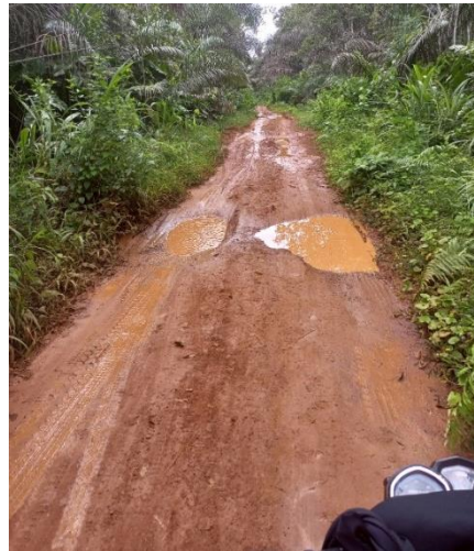
Planche photo 9 : Etat des routes dans la zone du projet.
