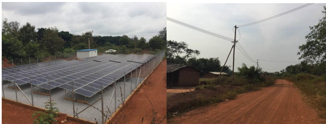
Photo 1: Centrale photovoltaïque de Ngoura.
