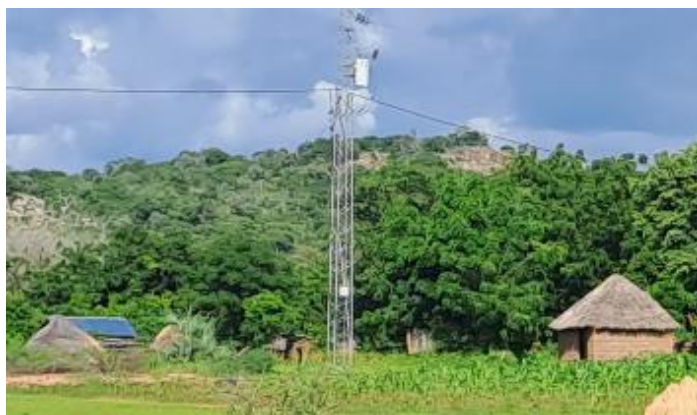
Figure 27: Vue du réseau électrique à Barkehi (Source : COMETE)
