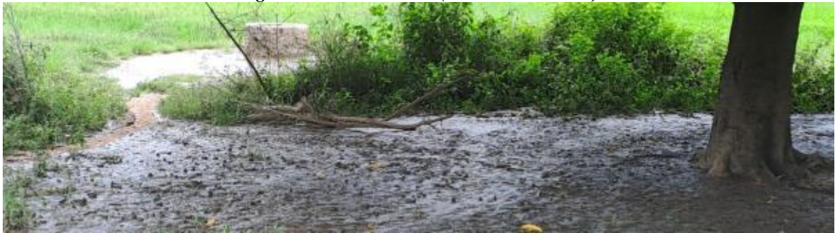
Figure 10: Puits à Tchiffel près du lac et vue de l'impact d'inondation (Source : COMETE)
